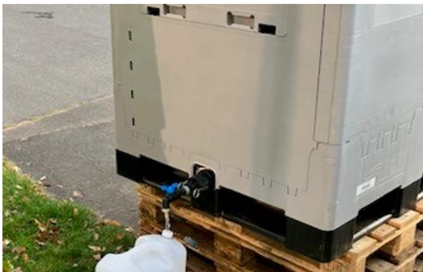
Figur 13 Tappning av vatten från nödvattentank
