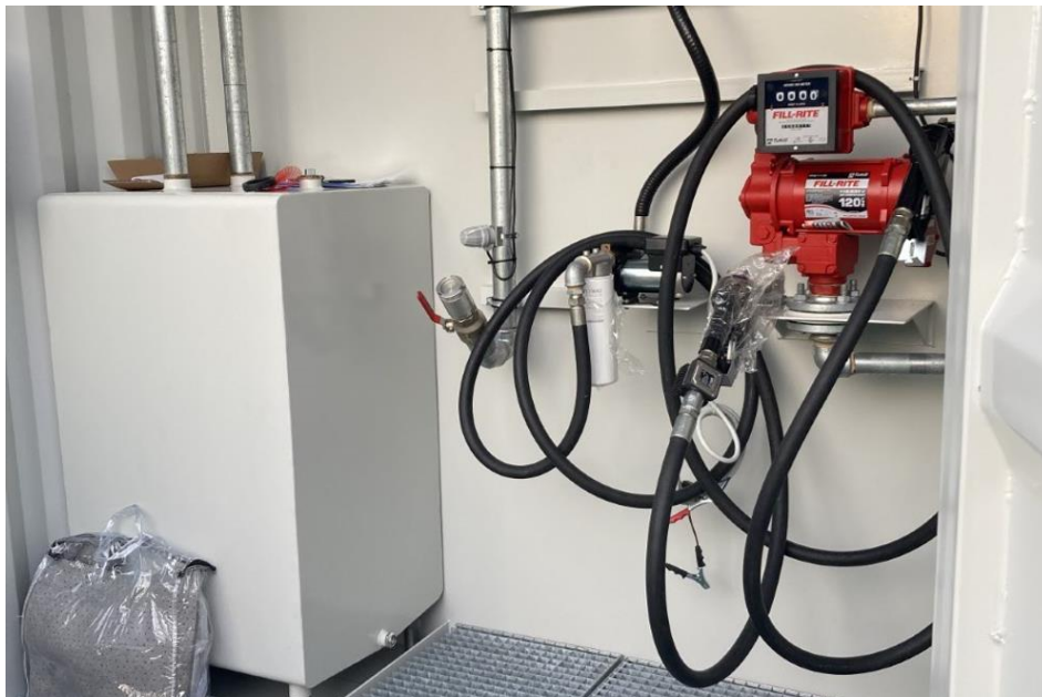
Figur 1 Reservkraftanläggning med bränslepump för tankning av drivmedel
