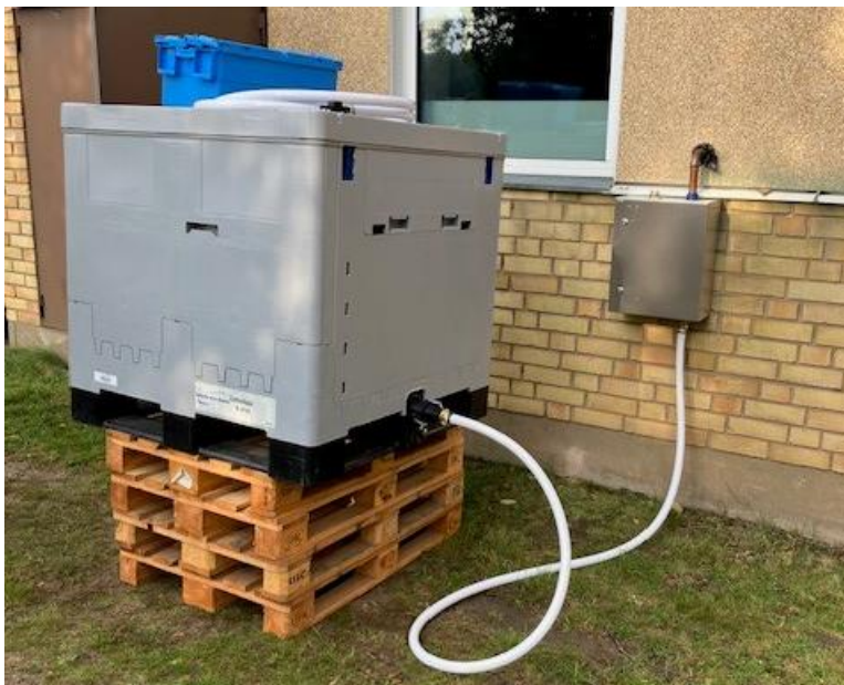
Figur 7 Vattentank och anslutningspunkt för nödvatten
