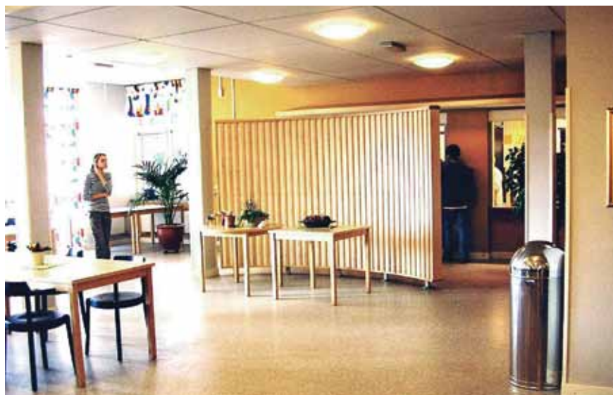
Exempel på platsbyggd, 2-sidigt ljudabsorberande bullerskärm mot kök. Matsal i Flatåsskolan, Göteborg.
